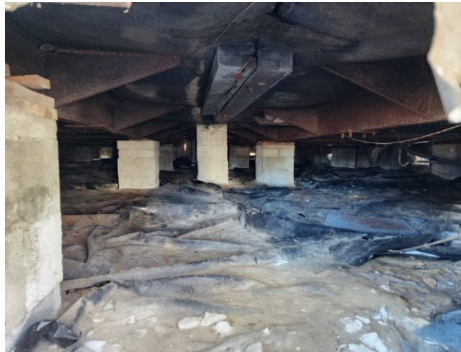
Figura 3: Ejemplo de chasis metálicos de una vivienda construida según el código del HUD.
