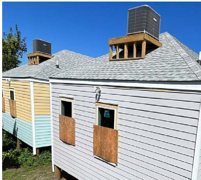
Figura 1: Plataforma de soporte con estructura de madera construida sobre el área del techo de una vivienda.
