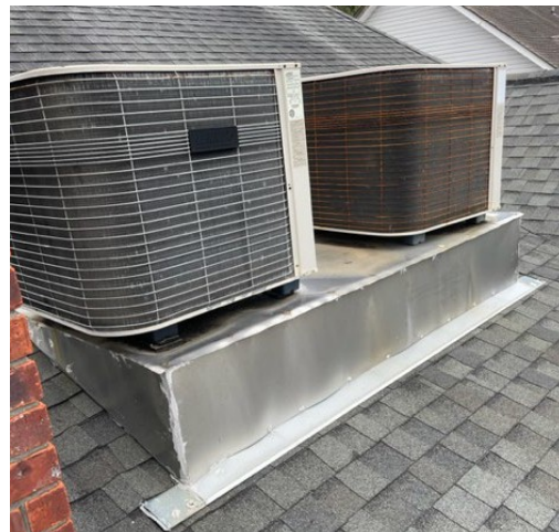
Figura 2: Estructura metálica de soporte sobre el área del techo de una vivienda.
